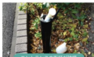
エントランスの街灯が破損
