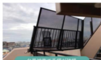
台風被害で手摺が破損
