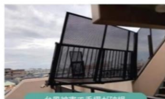
台風被害で手摺が破損 ▶▶▶ 協力会社へ即日手配 手配が早い
