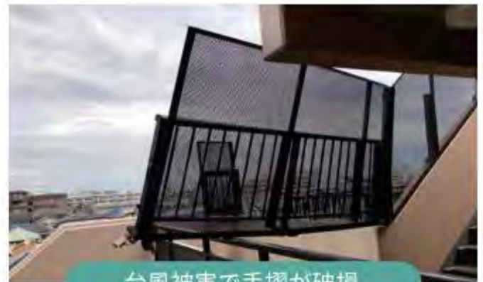
台風被害で手摺が破損
