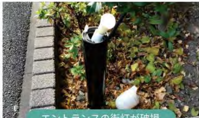
エントランスの街灯が破損
