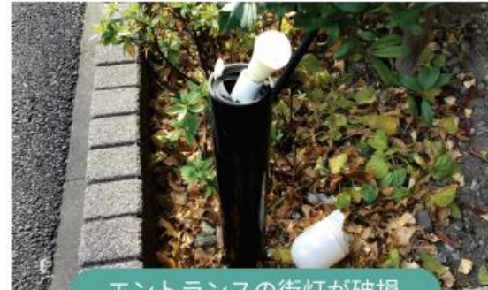
エントランスの街灯が破損
